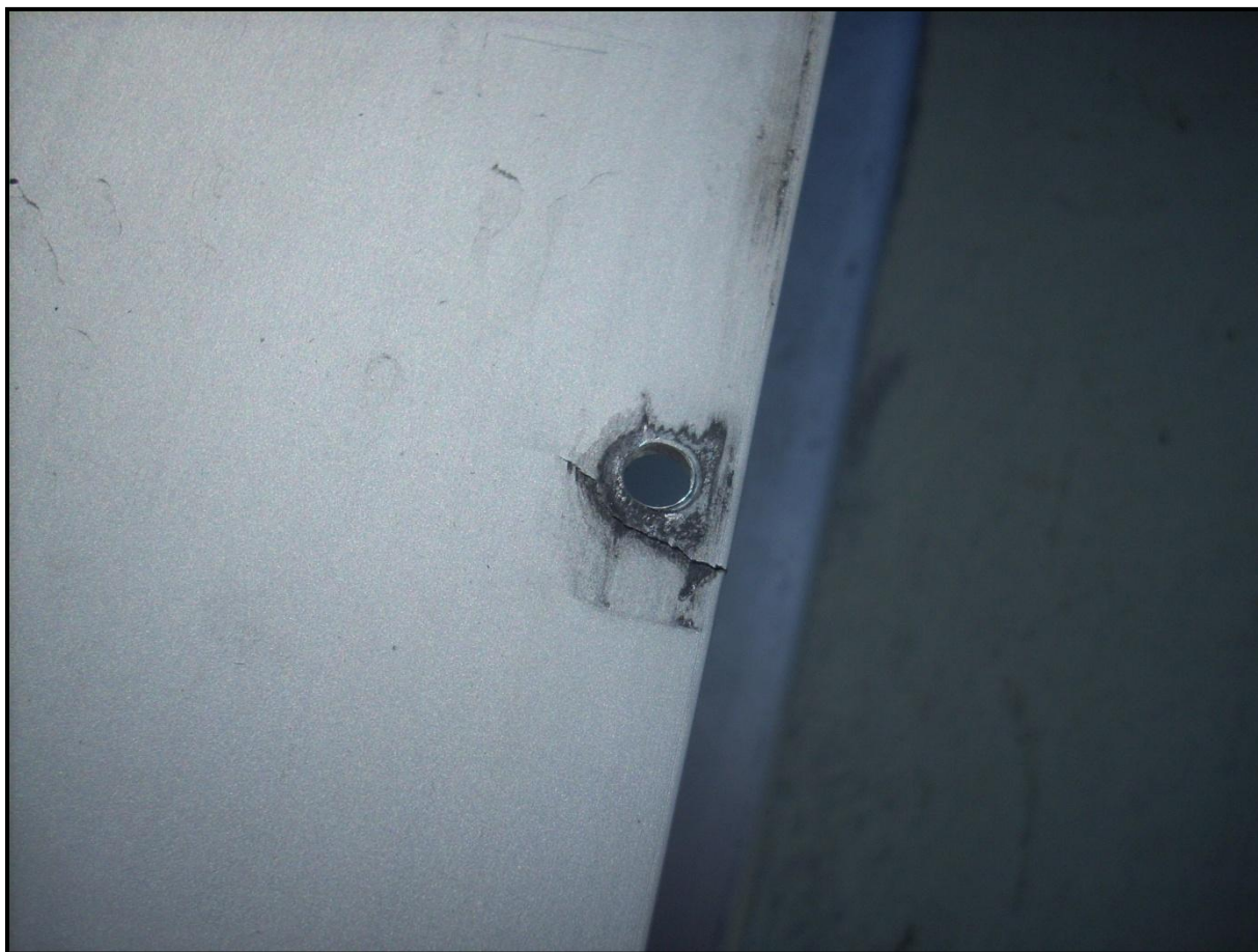
Zdjęcie 6. Przykład pęknięcia masztu – wymiana masztu obowiązkowa.
